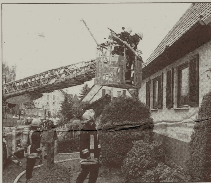
Mit Hilfe des aus Bodenheim angerückten Drehleiterwagens gelangten die Wehrleute auf das Dach des Hauses in der Nackenheimer „Bornwiese“. Von innen und außen wurde der Dachstuhlbrand nach dem Blitzeinschlag schnell unter Kontrolle gebracht.
